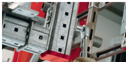
6 Soportería mecánica y eléctrica.
